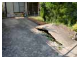
写真9、変形した宅地 - 以下の写真は、折立地区
