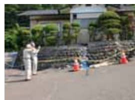
写真11、変形した石垣
