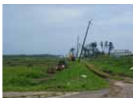
写真8、地震で変形した農道と傾いた電柱。一空港付近
